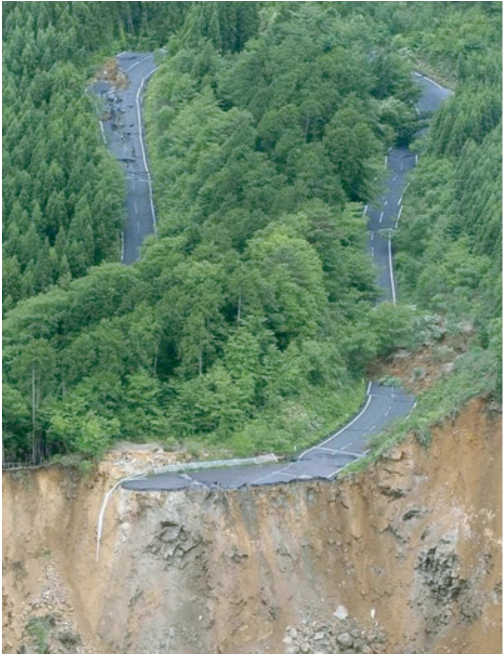
地震により陥没、崩落した道路
