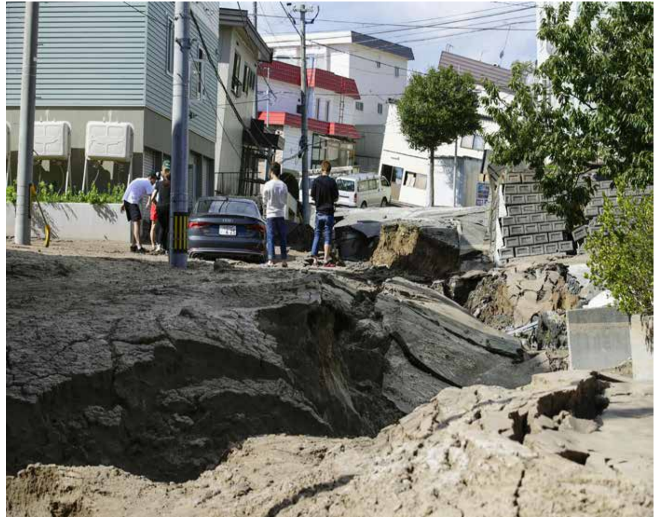
地震により陥没した道路と傾いた建物（奥）＝6日午前9時24分、札幌市清田区
